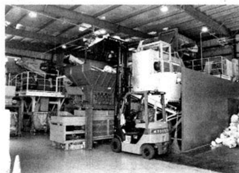
第7工場の処理ライン
